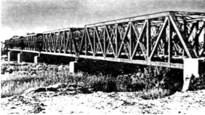
Fig. 23: Vista actual, desde la margen derecha, de los cinco tramos que componen el puente Palmira del ex F.C. Buenos Aires al Pacífico sobre el río Mendoza.
