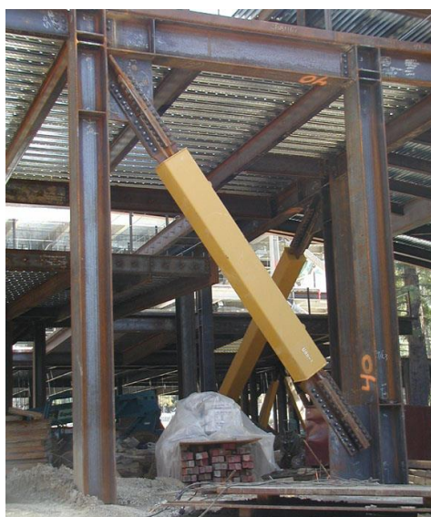
Fig. 3-20. Vista de una riostra de pandeo restringido utilizada en nuevo edificio de la Universidad de California, Berkeley (Cortesía de EERC, University of California, Berkeley).
