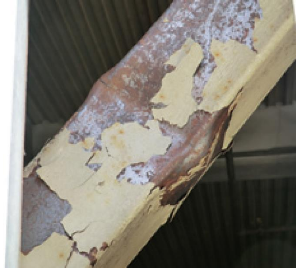
Fig. 1-20. Pandeo local en el extremo de una riostra de acero (Midorikawa et al., 2012).
