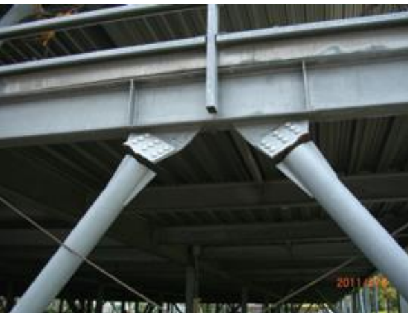
Fig. 1-19. Fractura de riostras en la zona de conexión (Midorikawa et al., 2012).
