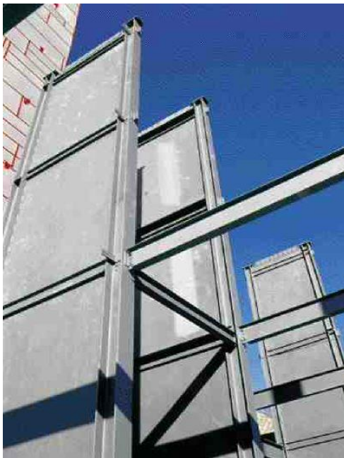
Fig. 3-23. Ejemplo de muros de corte con placas de acero en un edificio en construcción.
