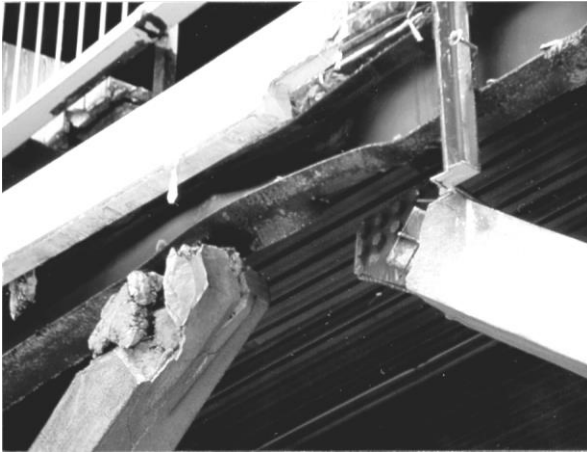
Fig. 1-17. Daño severo en la viga y conexión de un pórtico con arriostramientos en V invertida (Naeim, 2001).
