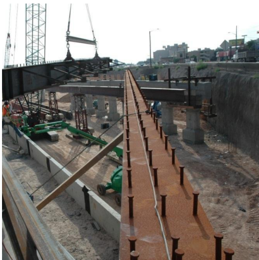
Fig. 1-33. Imagen de una viga de acero con pernos de corte para construcción de la viga compuesta de un puente.
