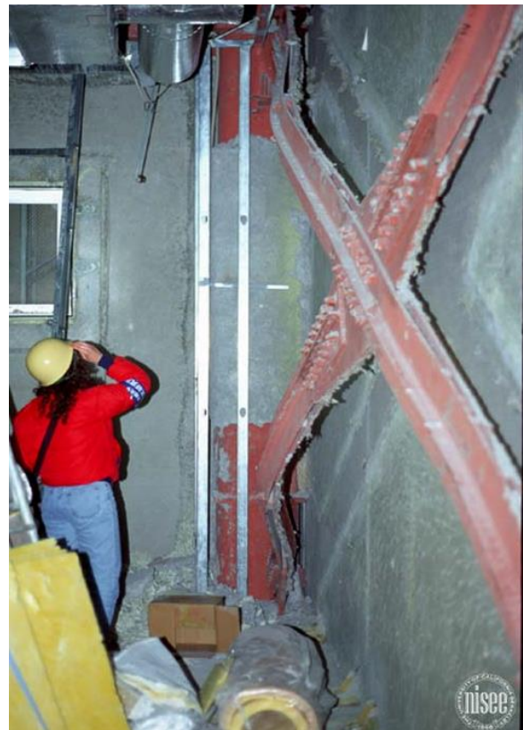
Fig. 1-6. Pandeo de una riostra, terremoto de Hyogo-ken Nanbu, Japón (Cortesía de National Information Service for Earthquake Engineering, EERC, University of California, Berkeley).
